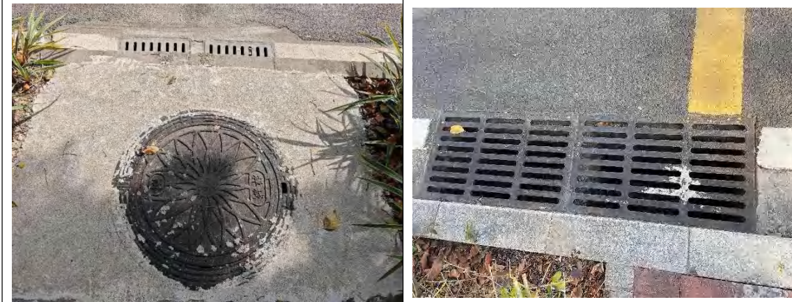
项目建成后雨水排水管
